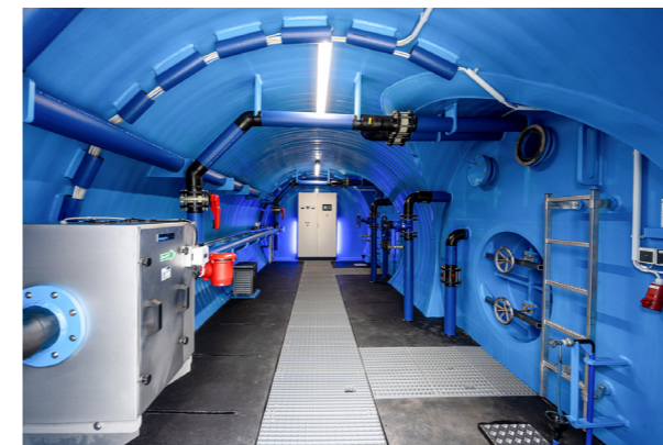
Innenansicht Schieberkammer inkl. technischer Ausrüstung
