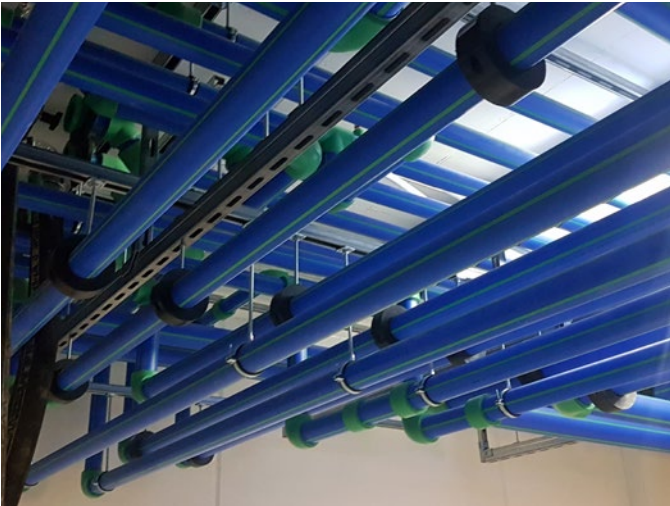
Für die gesamte Kälteverrohrung des CIO wurde aquatherm blue pipe eingesetzt. Foto: aquatherm GmbH
