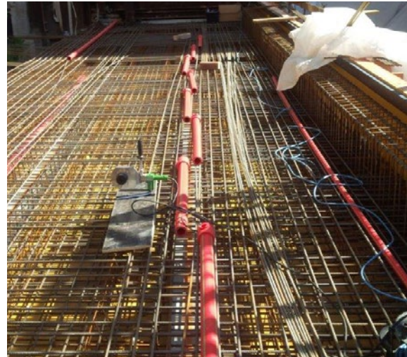
Das Kunststoff-Sprinklerrohrleitungssystem aquatherm red pipe sorgt in der James-Simon-Galerie für Sicherheit.
