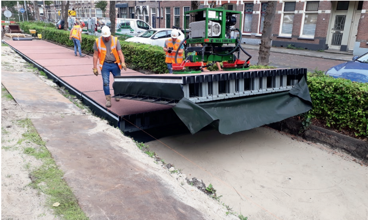
Die Straße aus Kunststoff überzeugt durch ihr leichtes Handling vor Ort auf der Baustelle.
