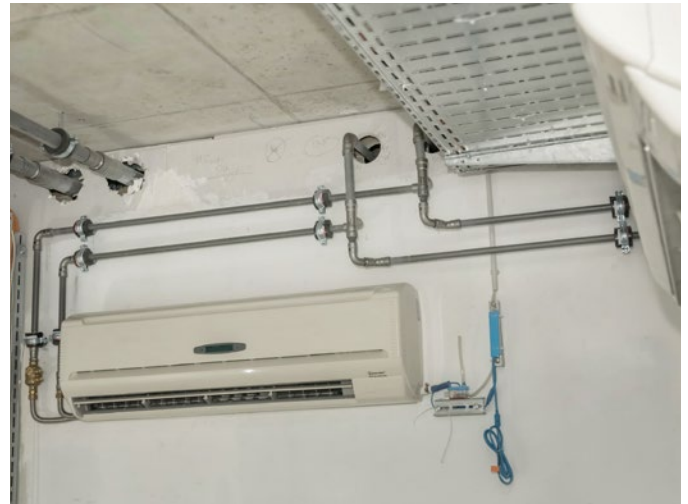
Auch für die Anbindung der Klimageräte kam das Viega-Rohrleitungssystem „Megapress“ zum Einsatz.
