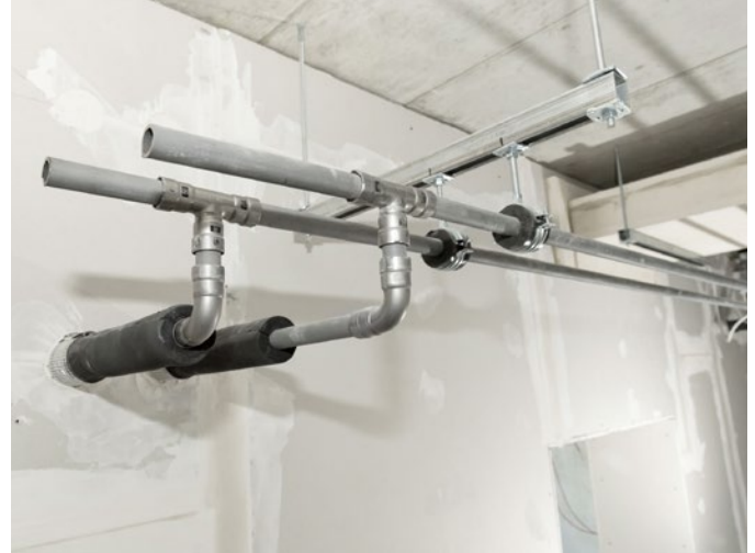
Rund 2,4 Kilometer Rohr und fast 2.500 „Megapress“-Verbindern von Viega wurden für die Wärme- und Kühleitungen installiert.
