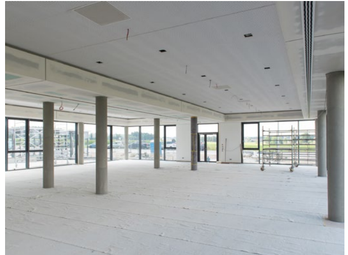
Kühldecken sorgen in der großzügig verglasten Kantine des Neubaus für angenehme Temperaturen zu allen Jahreszeiten.
