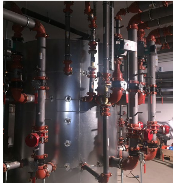
Das erste CO 2 -neutrale ICE-Instandhaltungswerk der Deutschen Bahn wird durch ein hochmodernes Kühlwasser-Heizsystem mittels Geothermie klimatisiert. Victaulic lieferte für die Bahn genutete Rohrkupplungen, Armaturen und Formteile. (Quelle: Victaulic)
