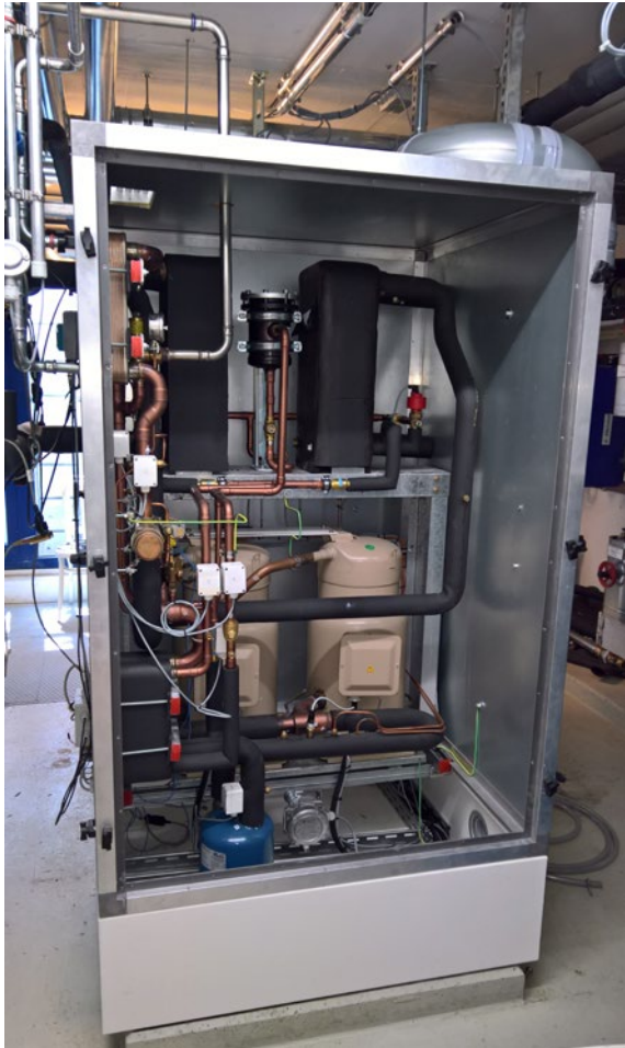
Die mit Propan betriebene Kältemaschine ist für die Raumklimatisierung vor allem im Sommer zuständig.
