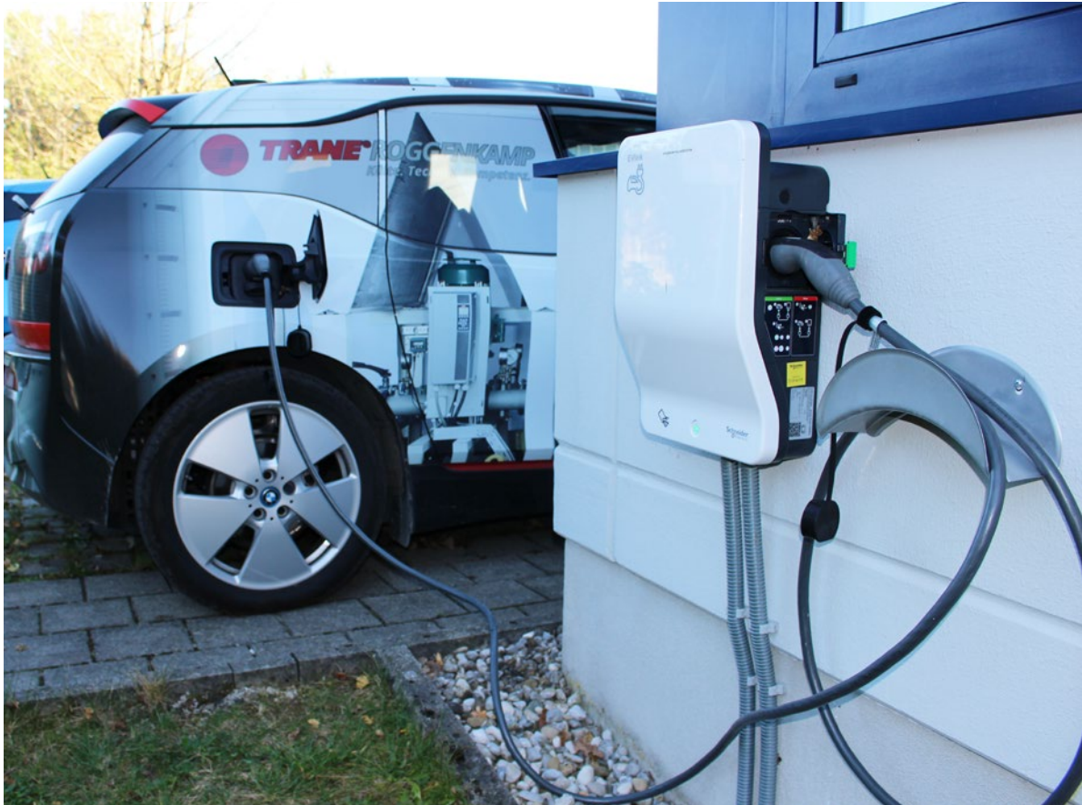
Der mit der PV-Anlage erzeugte Strom wird auch zum Laden der Batterien von E-Fahrzeugen genutzt.
