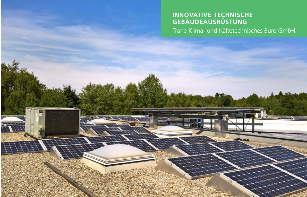
Mit der 50-kWp-Photovoltaikanlage deckt Trane Roggenkamp einen großen Teil seines Strombedarfs.
