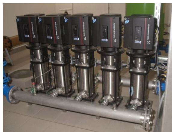
Nach dem Austausch der Pumpentechnik im GPW Wolkertsham. Die Aufgabe übernimmt eine Hydro MPC-E 5 CRIE 10-9. Steuereinheit CU 354: alle relevanten Daten stehen auf dem Display zur Verfügung.
