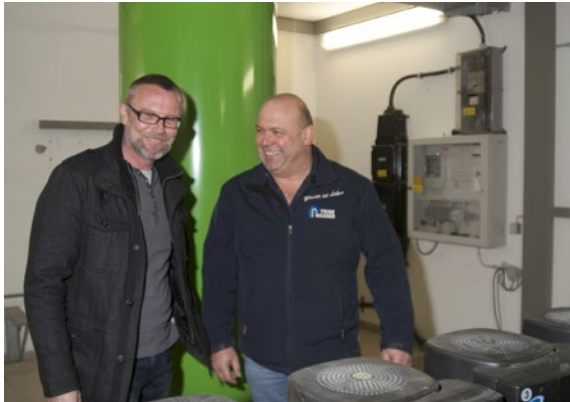
Anlage in Wolkertsham, links: Patrick Link-Walter, Außendienstmitarbeiter Wasserwirtschaft GRUNDFOS; rechts: Roland Kainz, Wassermeister, ZV Wasserversorgung Rottal
