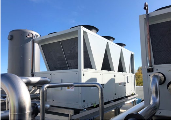
Bild 3: Flüssigkeitskühler (450 kW) für Prozesskühlung; Kältemittel R290 Propan
