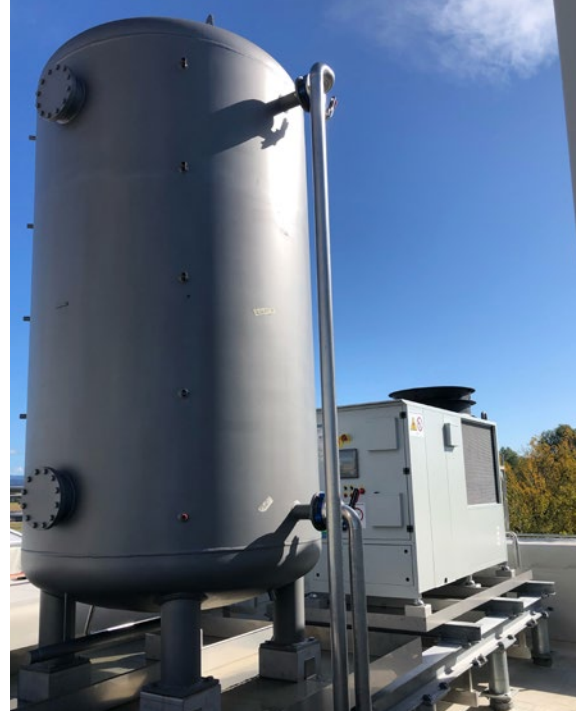
Bild 4: PCM-Latentspeicher 5 m³ mit Flüssigkeitskühler (50 kW) als Lademaschine
