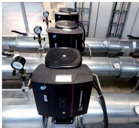
Netzpumpen in der Energiezentrale (Foto: Team für Technik GmbH)
