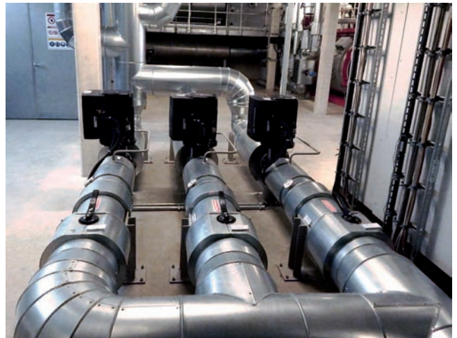
Netzpumpen in der Energiezentrale (Foto: Team für Technik GmbH)
