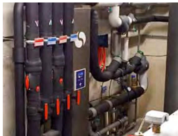
Die Seccua Filteranlage zur Legionellenentfernung, platzsparend zwischen den Leitungen im Technikraum.
