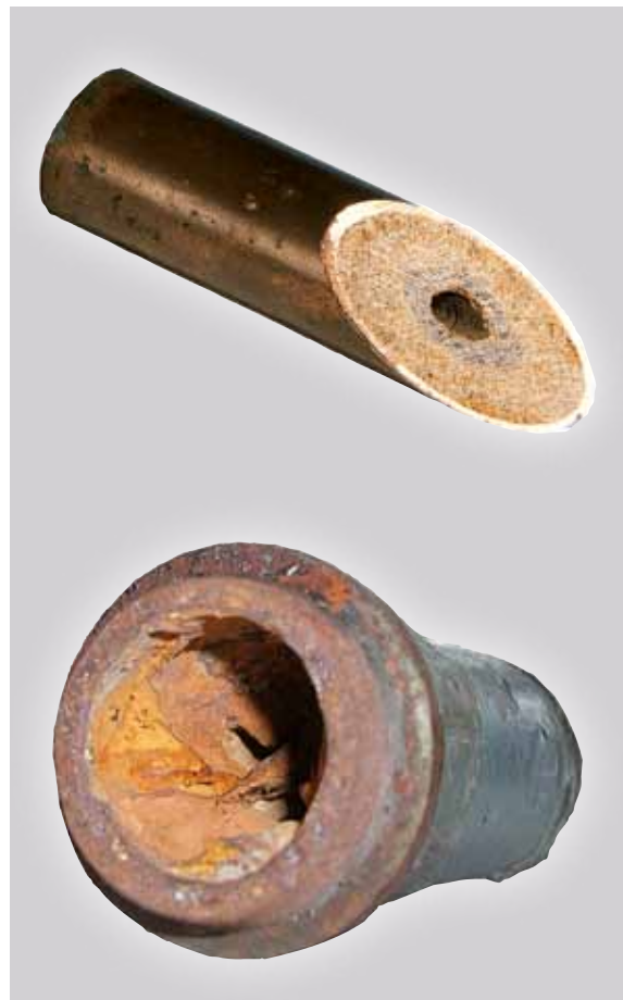
Verkalkte und korrodierte Rohre stellen mit ihrer zerklüfteten Oberfläche eine ideale Brutstätte für Keime dar.
