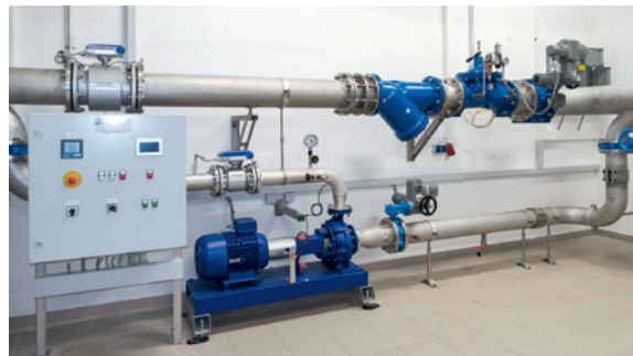
Turbinenpumpe Daibersdorf – Ausführung
