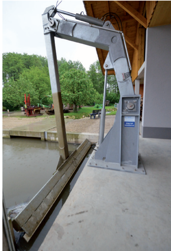
Der neue Teleskoparm-Rechenreiniger wurde von Onnen-Krieger geliefert. Er sorgt für einen freien Durchfluss am Feinrechen – zuverlässig und natürlich vollautomatisch.
