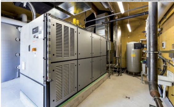
Die Heizzentrale von außen. Die Anlage von innen.
