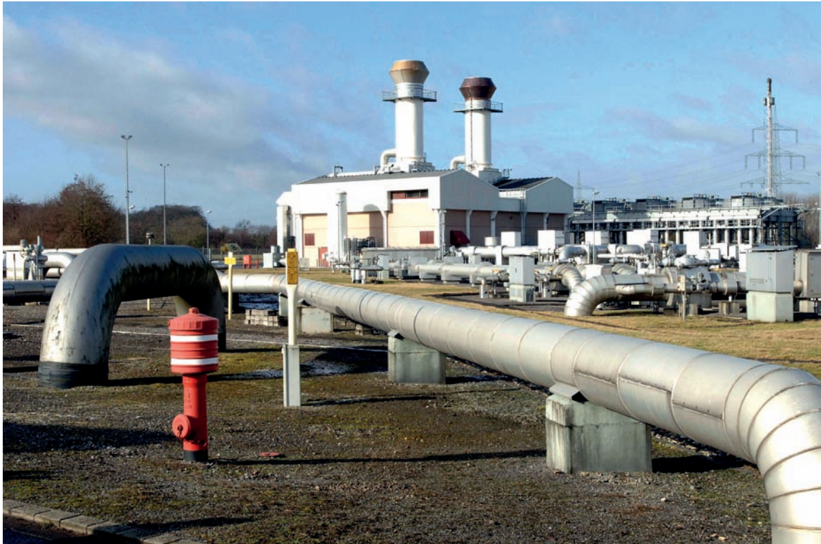
Verdichterstation Werne der Open Grid Europe (OGE)
