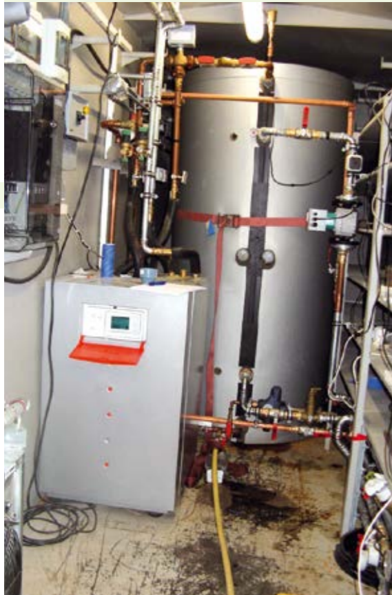
Bild 2: Messcontainer mit Wärmepumpe (iro, Oldenburg)
