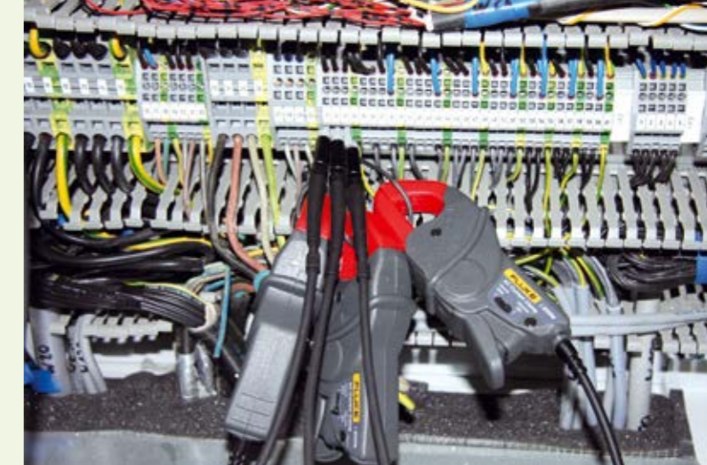
Abbildung 2: Messung des Eigenenergieverbrauchs
