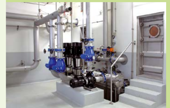
Abbildung 5: Energieeffiziente Pumpen fördern aus dem Zwischenbehälter ins Netz
