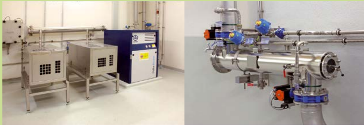
Abbildung 3: Oxidator® (linkes Bild) und Ferrox® (rechtes Bild) im Betrieb in der Aufbereitungsanlage in Angkofen
