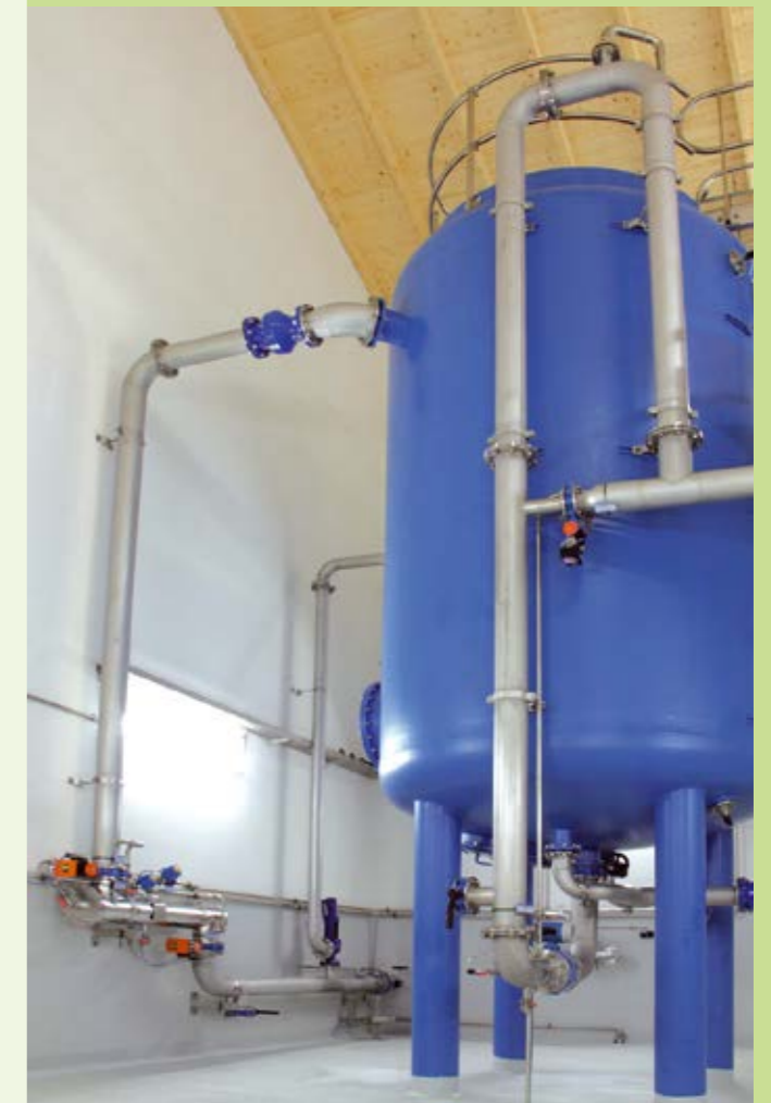
Abbildung 4: Filterkessel in der Aufbereitungsanlage Angkofen
