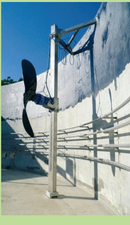
Ein langsam drehendes Tauchmotorrührwerk von KSB ersetzt die schnelldrehenden Stabmixer.
