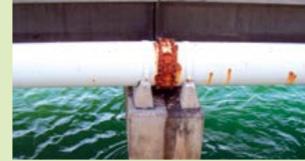
Die äußeren Einflüsse haben besonders im Bereich der Verbindungen zu Korrosionsschäden geführt.
