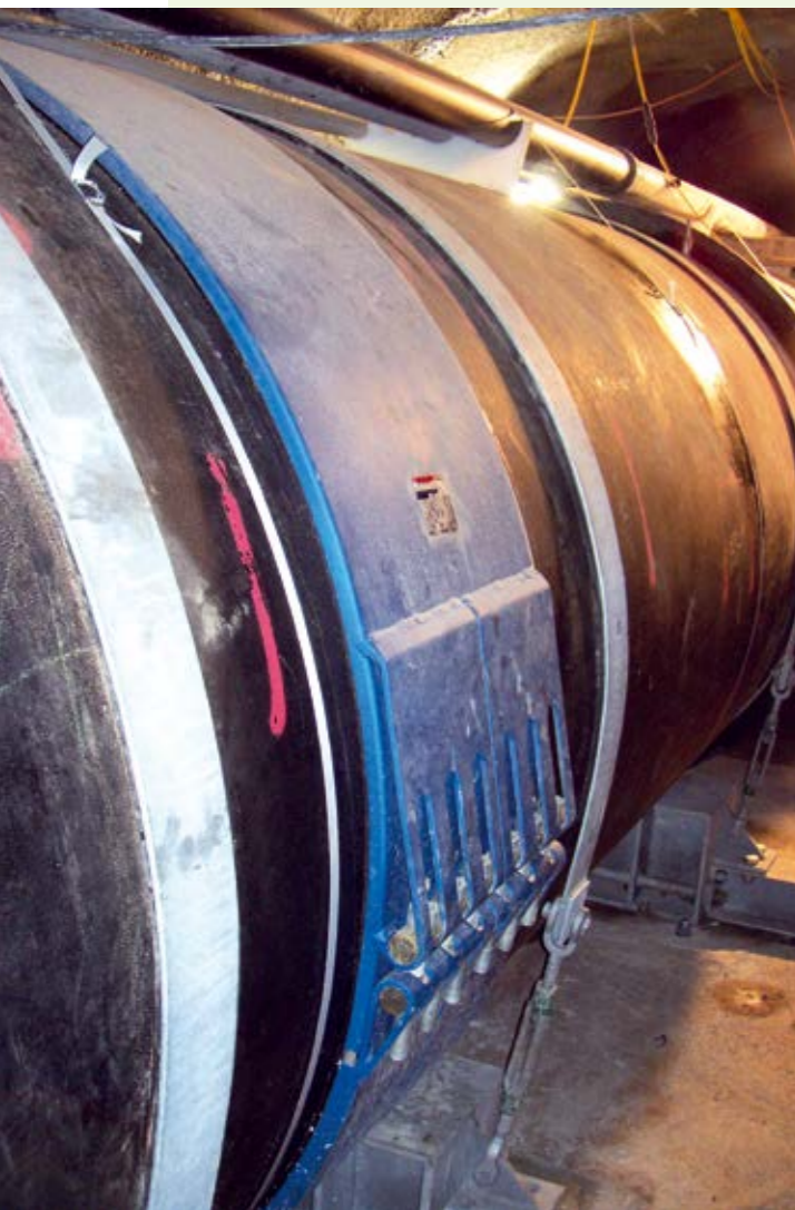
Eingesetzt wurde ein zweiteiliges Gehäuse, welches eine nachträgliche Montage ohne Bewegungen der Rohre ermöglichte.
