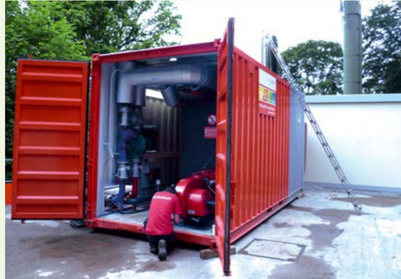
Eine mobile Heizzentrale von mobiheat mit einer Leistung von 2 MW übernahm während der rund 8-wöchigen Umbauphase des Fernheizkraftwerks Badenweiler die Wärmeversorgung der Kur- und Badeeinrichtungen.
