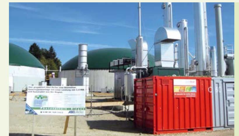
Zur Inbetriebnahme der Biogasanlage in Egg bei Mammendorf wurde eine mobile 600 kW-Heizzentrale von mobiheat eingesetzt, die für die richtige Betriebstemperatur im Fermenter sorgte und somit als Aufheizhilfe diente.
