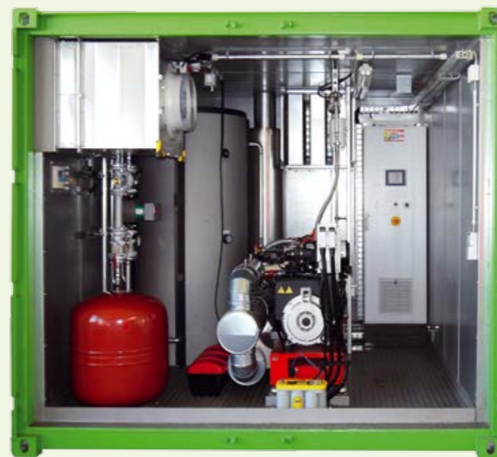
Das voll funktionsfähige mobile Blockheizkraftwerk im schalldämmten Stahl-Technik-Container erzeugt hoch-effizient Wärme und Strom mit einer elektrischen Leistung von 20 kW und einer thermischen Leistung von ca. 40 kW. Es werden Gesamtwirkungsgrade bis 90% erreicht.
