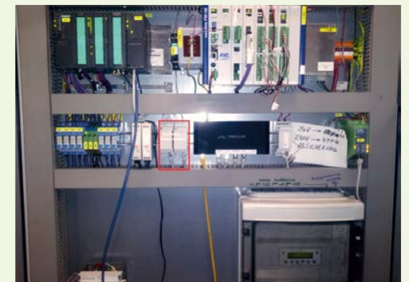
Abbildung 3: SPS-Schaltschrank mit KraftWare®-HUT-Komponenten zur Messwerterfassung
